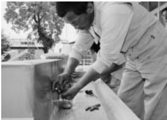
子ども達のため、園庭手洗い場の水漏れを直す組合員
