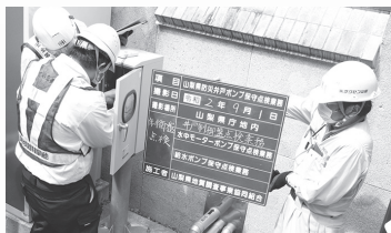
ポンプの電気系統を点検
