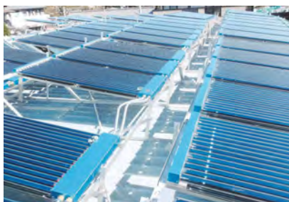
屋根に設置した太陽熱交換真空管コレクター
