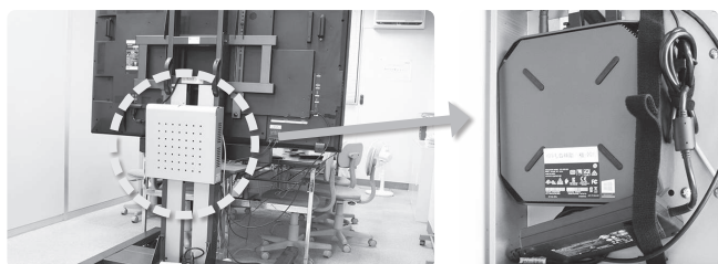
デジタルサイネージの裏面に設置された、「M*Board」システムが格納されている「セットトップボックス」
